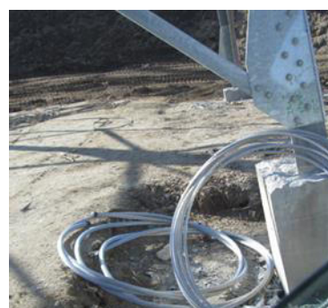
Cabos de aço
